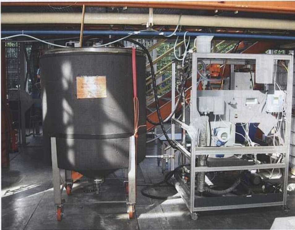
Biomembran-Reaktor; links isolierter Behälter mit 1 m 3 Reaktionsvolumen; rechts Überwachungsperipherie im F+E- Betrieb mit Keramikmembran der Firma Atech
